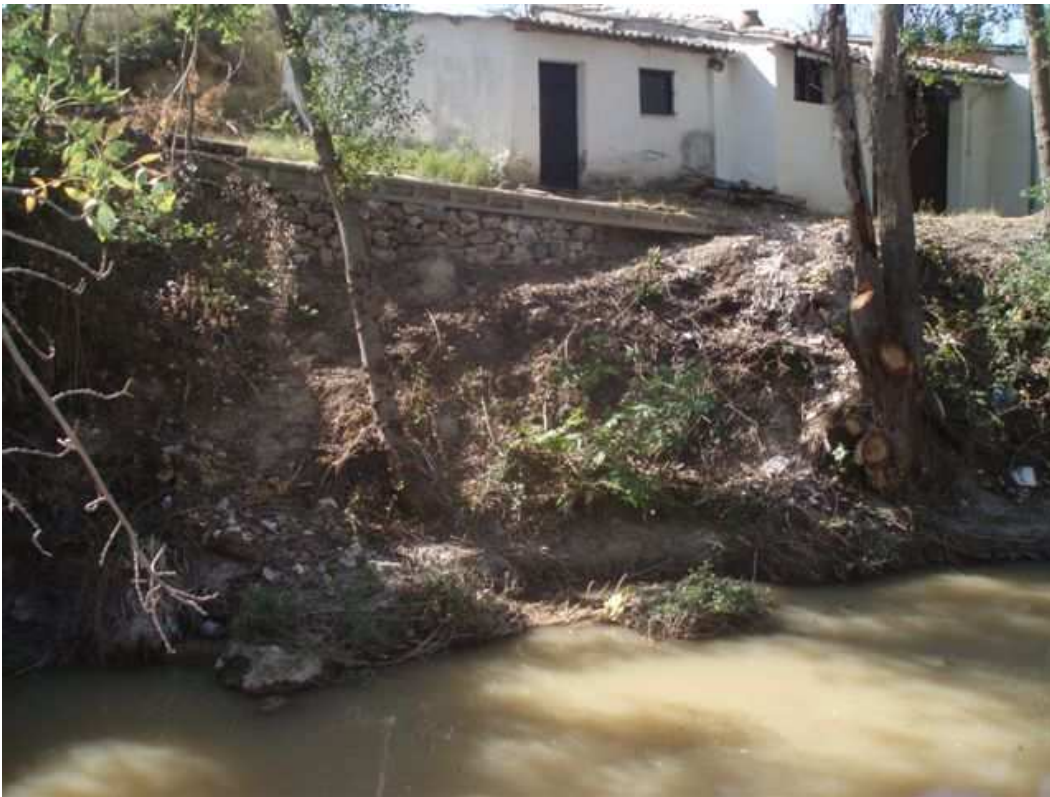
Margen del río descalzado por la acción erosiva del agua. Peligra la construcción existente en coronación
