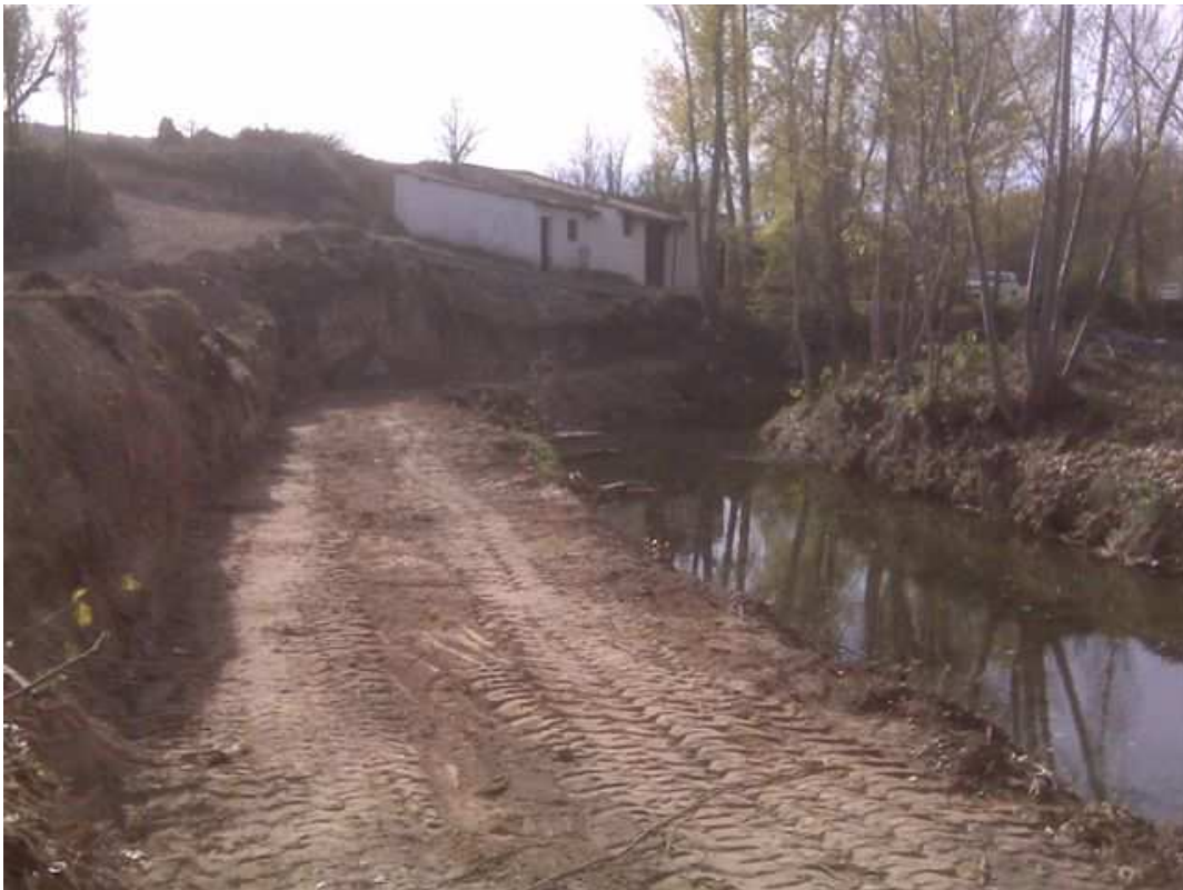
Cajeadado esperando la construcción de los geocolchones flexibles como asiento del muro.
