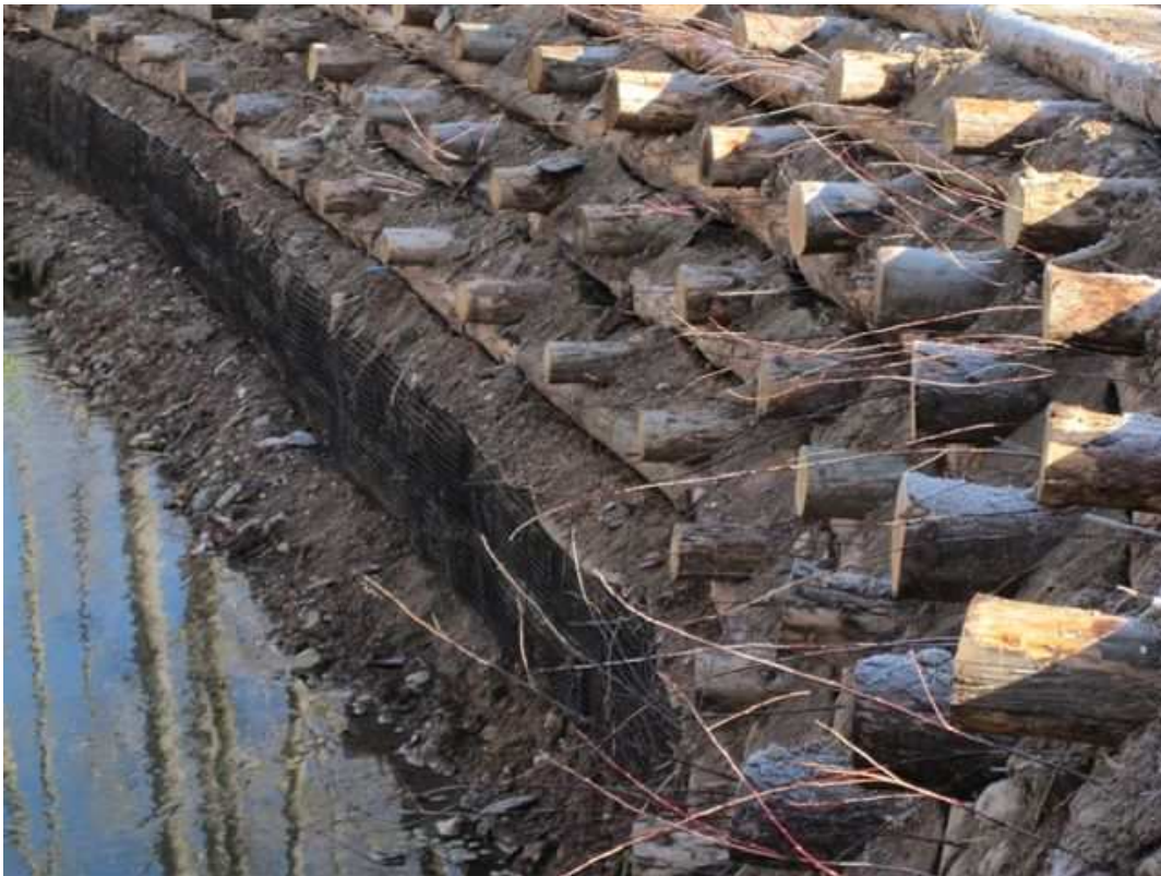
Detalle del muro; se observa el geocolchón, los salix, y troncos en el paramento.
